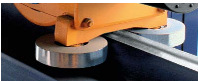
Führungsrollen an der oberen Kranbahn
