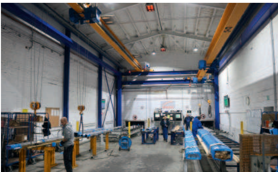
Hohe Verfügbarkeit: Durch die doppelte Kranbahn kann ein Kran bei Ausfall des anderen beide Ausgabestationen bedienen.
