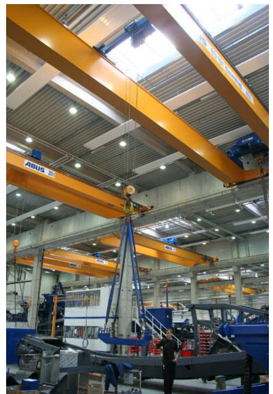
Wirtschaftlicher 10-Tonnen-Seilzug in der Montagelinie. Für die schweren Fälle steht zudem ein 63-Tonnen-Seilzug bereit
