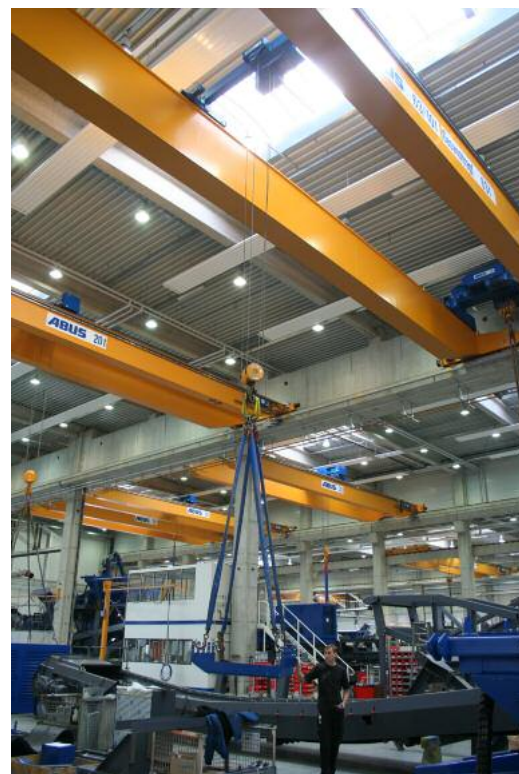
Wirtschaftlicher 10-Tonnen-Seilzug in der Montagelinie. Für die schweren Fälle steht zudem ein 63-Tonnen-Seilzug bereit
