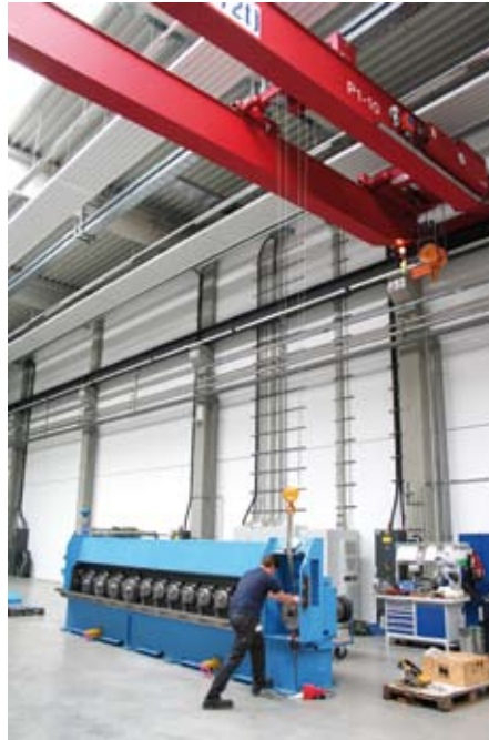
Bild 2: Alle Krane haben einen zusätzlichen 2-Tonnen-Hilfszug, mit dem Einzelteile gehoben werden
