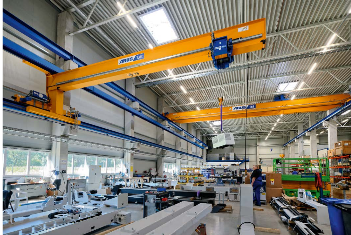
Kranbahn für Einträger-Wandlaufkran (EWL)
