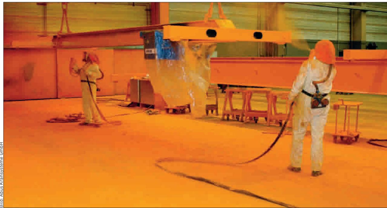
Beim Kranhersteller werden Laufkrane im Einkomponenten- und Einschichtverfahren lackiert. Bereits drei Stunden später erfolgt die vollständige Verkabelung des Krans.
